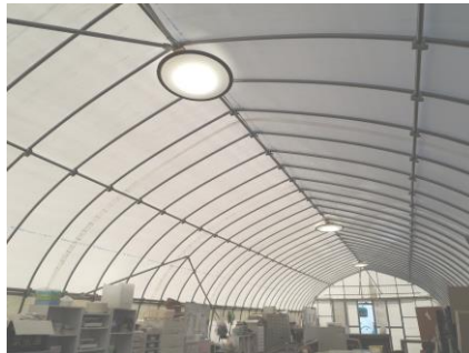
ビニールハウスですが、電気が点 きます。
